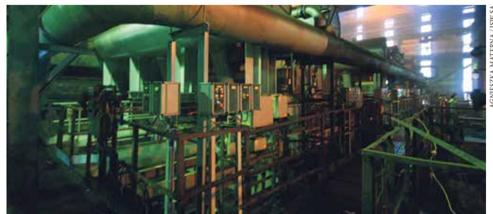
W kopalni pracuje obecnie sześć silników spalających metan i wytwarzających energię elektryczną
